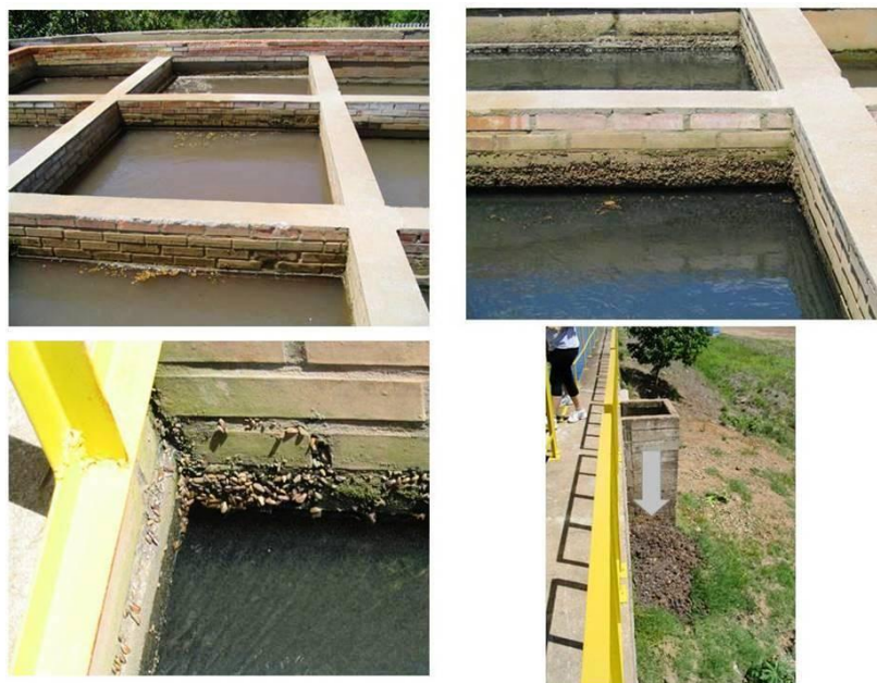
Figura 16 Estação da Corsan no Rio Grande do Sul mostrando a colonização de tanques pelo mexilhão-dourado e o resíduo removido. Foto: M.C.D.Mansur
