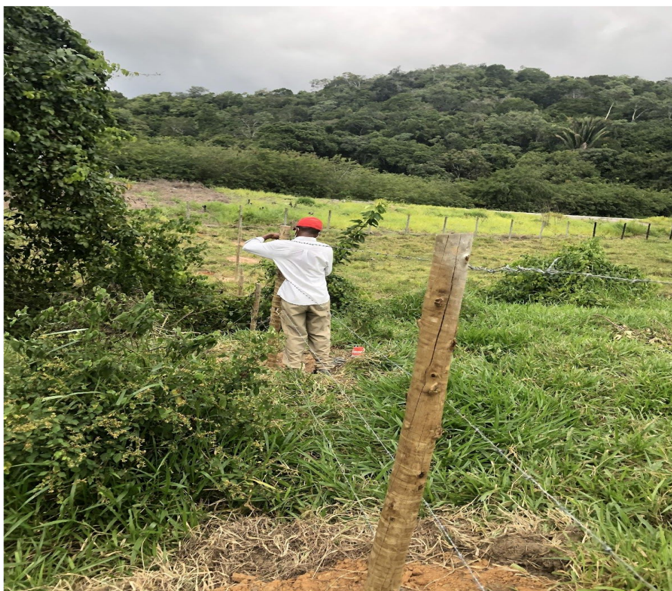
Foto 02 – Reparo das cercas divisórias, importante para não permitir entrada de animais domésticos dentro da área de recuperação ambiental
