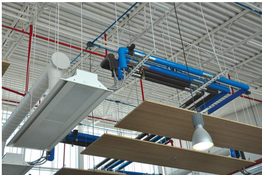
Figura 28 – Detalhe de um sistema de viga fria instalada no forro, indicando a tubulação de água gelada e o suprimento de ar primário (DOAS) desumidificado e tratado.
