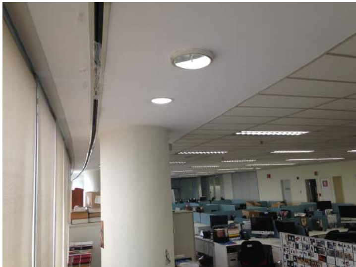
Figura 41 – Fitas adesivas colocadas pelos usuários bloqueando o fluxo de ar nos difusores.
