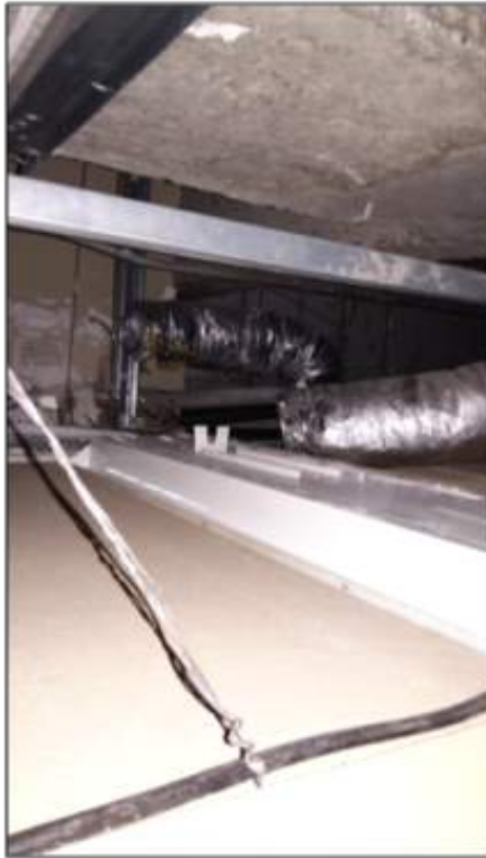
Figura 40 – Duto desencaixado do Troffer na luminária – Ar insuflado no forro.
