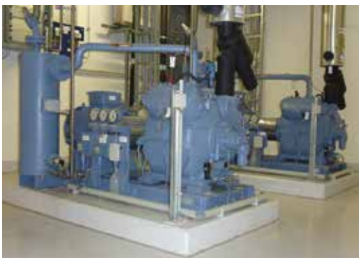
Imagem 3: Design adequado da disposição dos equipamentos dentro da sala de máquinas.
