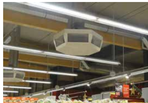
Imagem 1: Insuflação de ar adequada na área dos balcões e expositores refrigerados.
