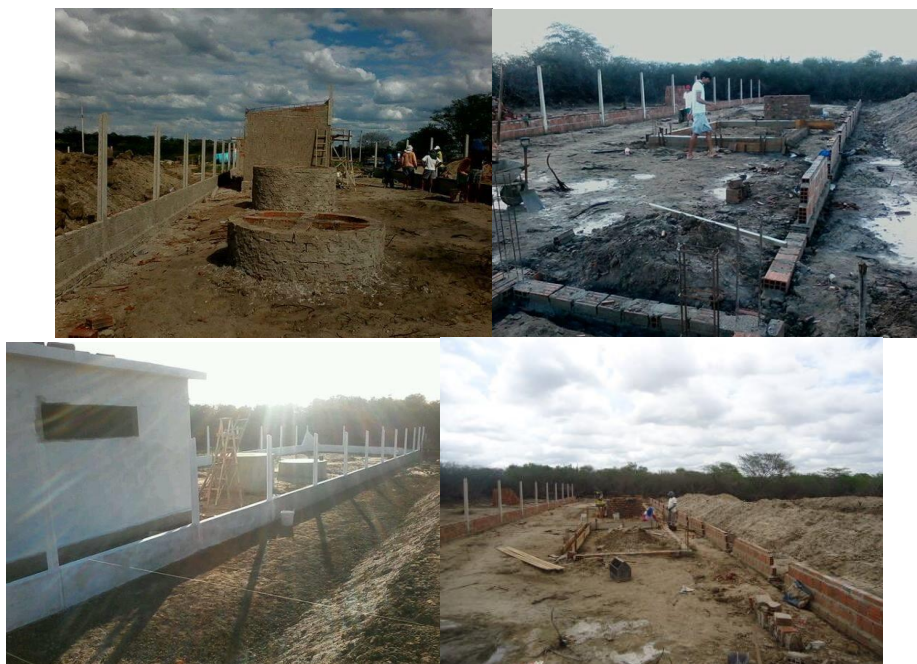
Figura 11e 12 – Obras em Nova Palmeira, Papafina.
