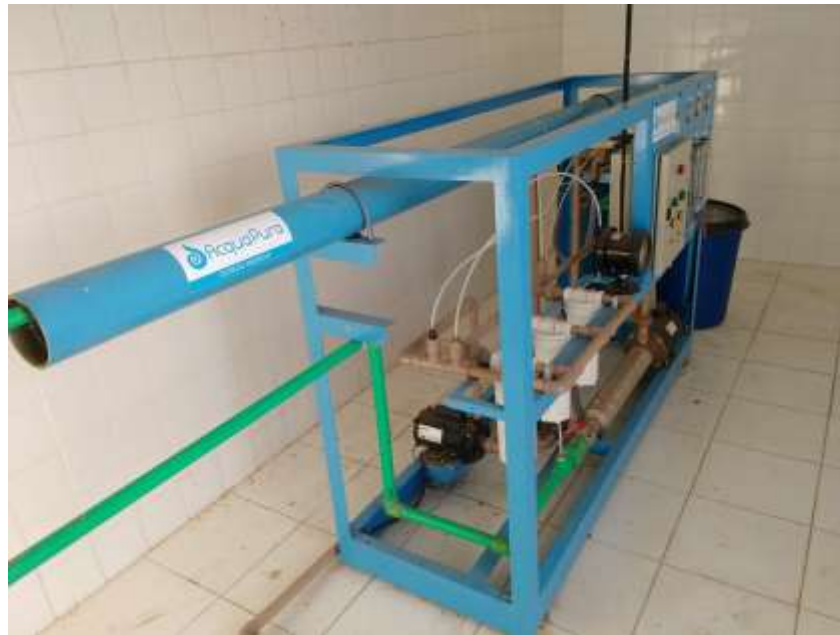
Figura 28. Equipamento de dessalinização da comunidade dos Valérios.
