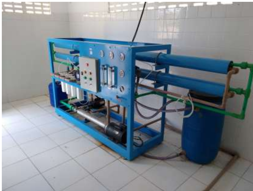
Figura 33. Equipamento de dessalinização da comunidade Grotão.
