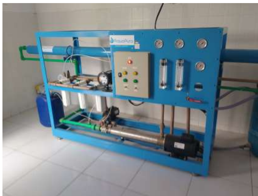
Figura 29. Equipamento de dessalinização da comunidade Manuê.
