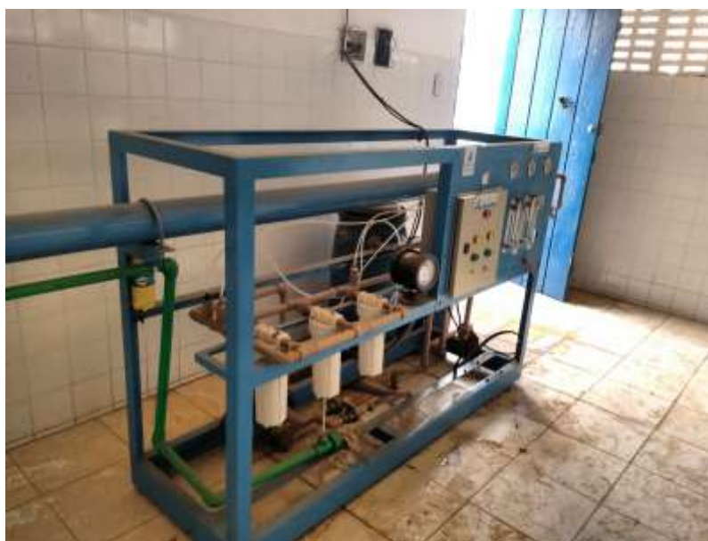
Figura 35. Equipamento de dessalinização da comunidade Santo Antonio.
