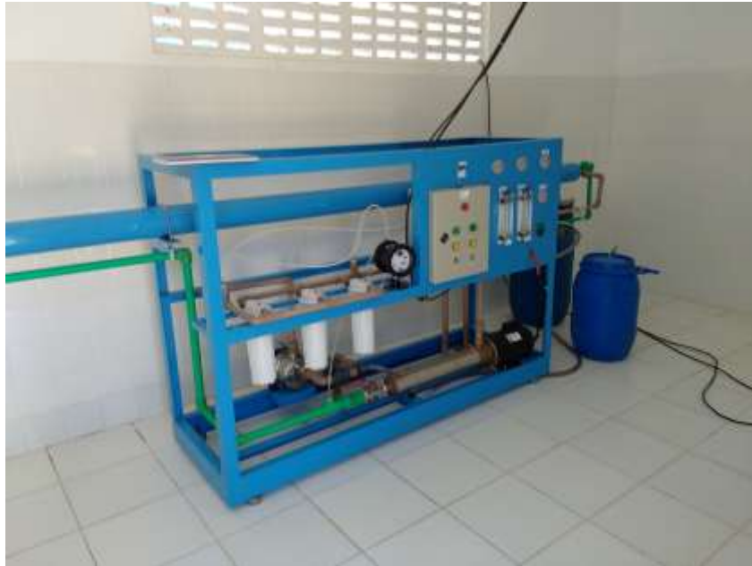
Figura 30. Equipamento de dessalinização da comunidade Gravatzinho.
