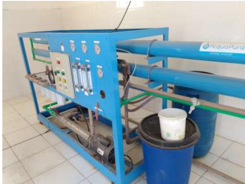
Figura 31. Equipamento de dessalinização da comunidade Várzea de Dona Joana.
