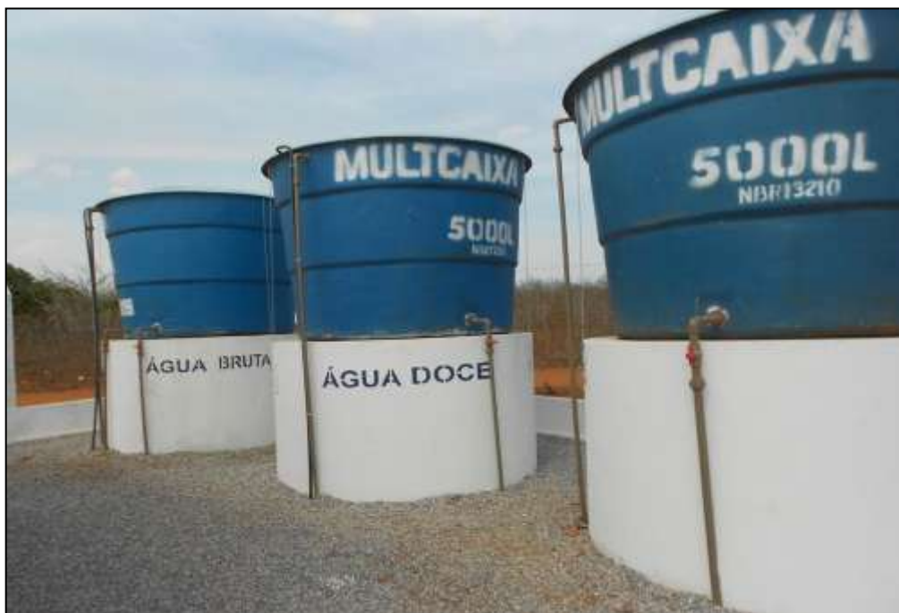
Figura 10 – Bases dos reservatórios
