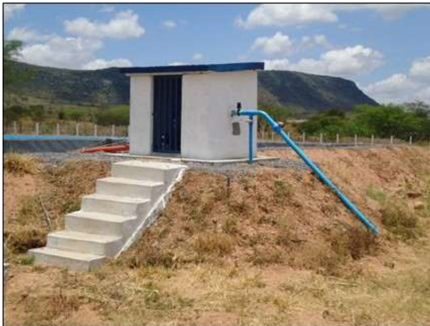
Figura 24 – Casa de bombas
