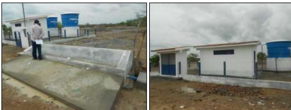
FIGURA 31, 32. Sistema de Dessalinização.
