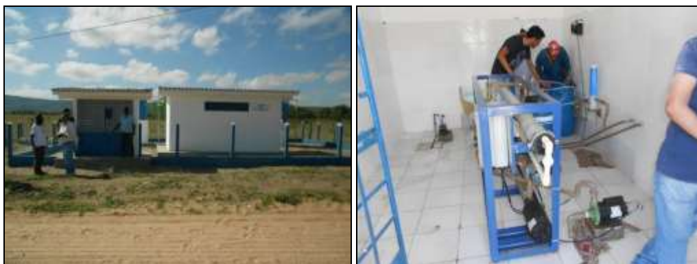
FIGURA 52, 53. Sistema de Dessalinização
