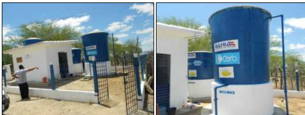
FIGURA 37, 38. Sistema de Dessalinização.
