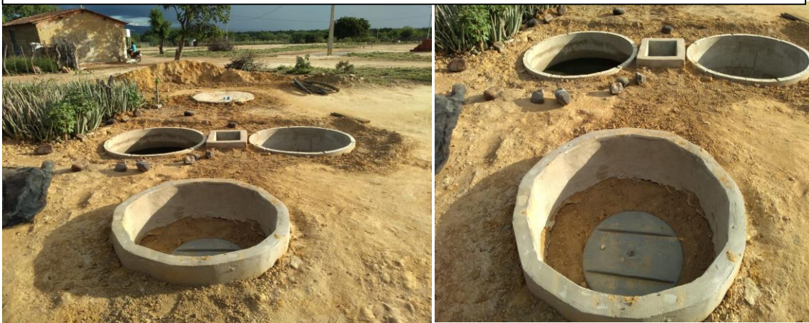
Imagens Sistema de tratamento de água residual total, com reator UASB.
