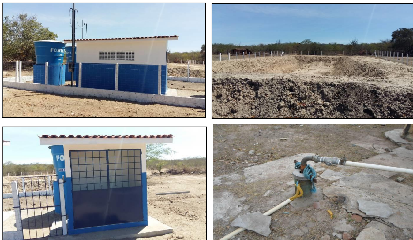
Figura 30,31,32 e 33- Sistema de Dessalinização, Tanque, Chafariz e Poço
