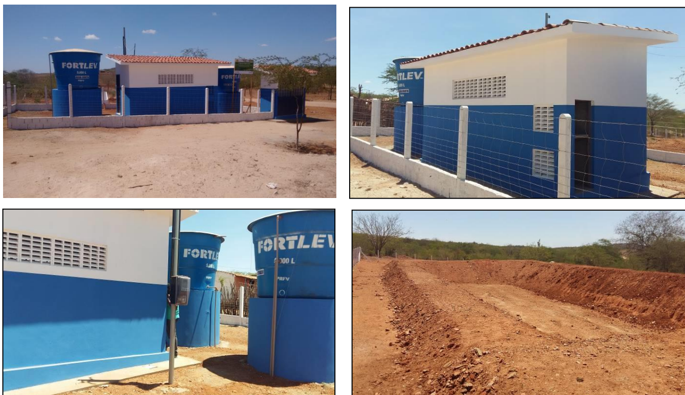
Figuras 20, 21, 22 e 23 - Sistema de Dessalinização e Tanque
