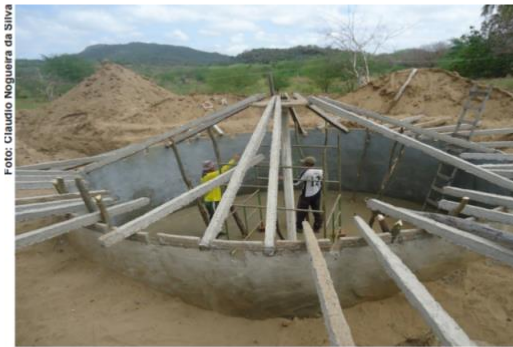
Imagem 7. Colocação das vigas ou estacas de concreto para estruturação da cobertura. Extraído de ARAÚJO ET AL(2018).
