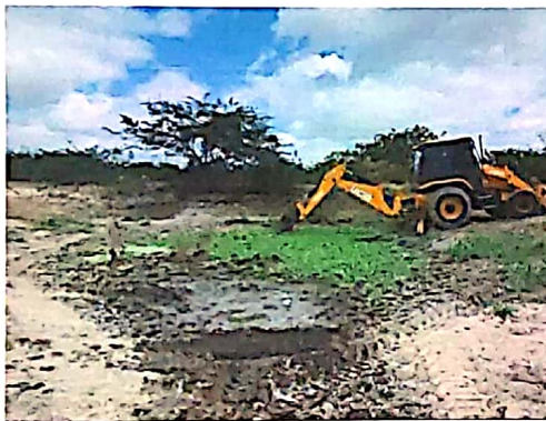
LOCALIZAÇÃO SERVIÇO POV. SÃO JOSÉ, POÇO REDONDO/SE REMOÇÃO DE SOLO (LAMA PODRE)
