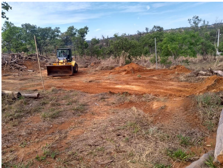
Figura 4. Local para instalação da Unidade Demonstrativa de produção de Carvão Vegetal e Galpão de apoio, em processo de nivelamento do terreno.
