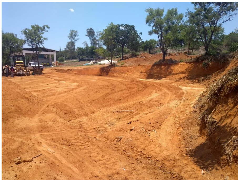
Figura 8. Área pronta para construção da Unidade Demonstrativa de Produção de Carvão Sustentável.
