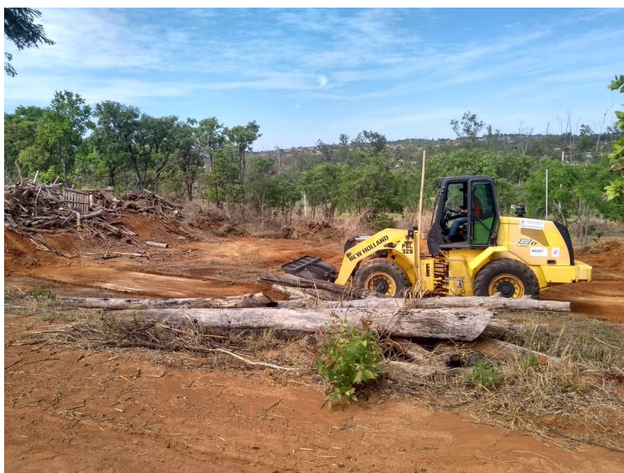
Figura 5. Local para instalação da Unidade Demonstrativa de produção de Carvão Vegetal e Galpão de apoio, em processo de nivelamento do terreno.
