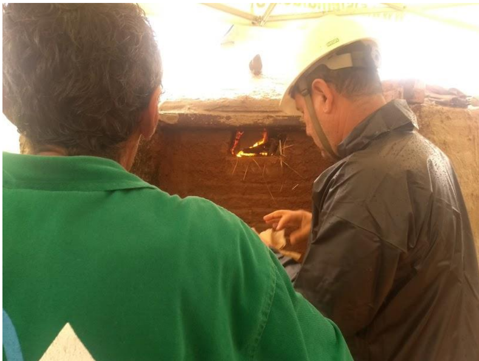
Figura 17. Ignição do forno durante o curso teórico-prático em produção sustentável de carvão vegetal ocorrido entre 05 à 07/02/2020.
