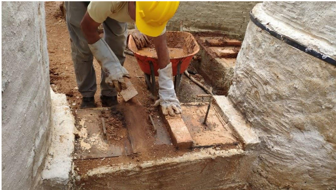
Figura 19. Vedação dos dutos para não ocorrer entrada de ar por eles durante o processo de carbonização.
