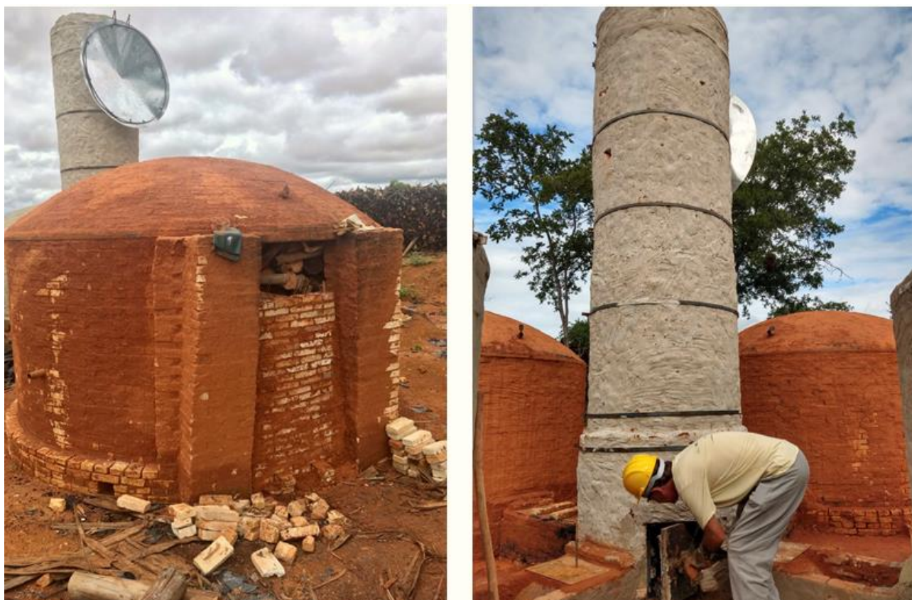
Figura 7. Fechamento dos fornos e abastecimento da fornalha.
