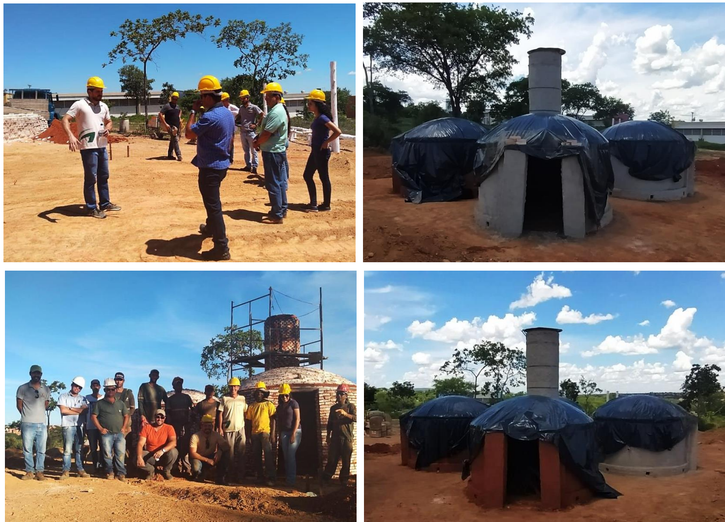
Figura 2. Curso prático de construção do sistema fornos-fornalha no campus de Montes Claros da UFMG.
