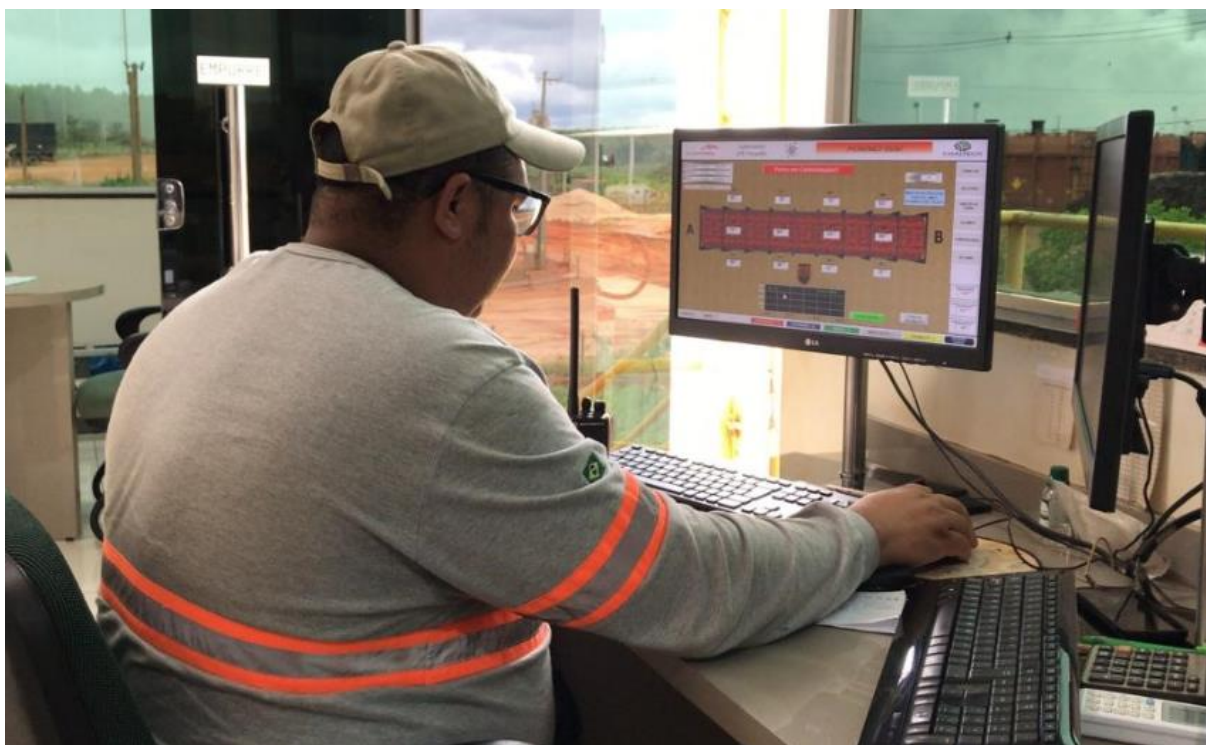
Sala de controle do sistema de supervisão dos fornos – UPE Forquilha – Carbonita – MG
