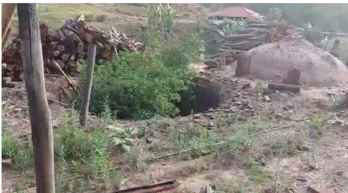
Fig.6 – Detalhe do local onde um dos fornos cedeu a estrutura integralmente
