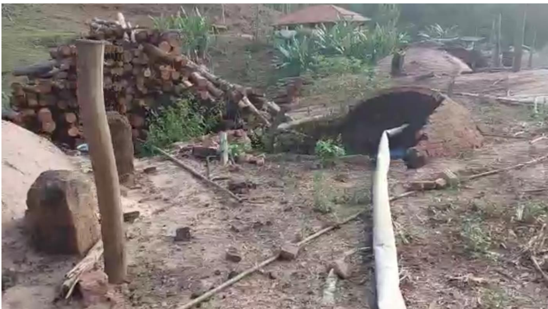
Fig.7 – Detalhe do local onde a estrutura de um dos fornos cedeu parcialmente
