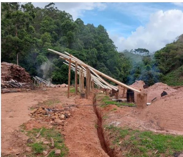
Fig. 26 – Detalhe da canaleta pra escoamento da fumaça condensada par os tanques de coleta
