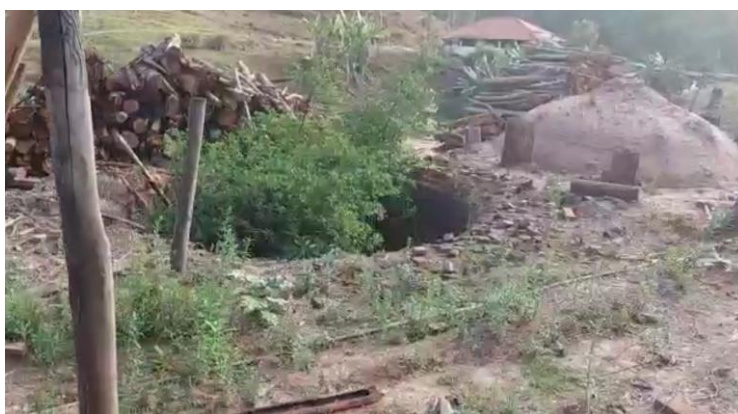
Fig. 06 – Detalhe do local onde um dos fornos cedeu a estrutura integralmente
