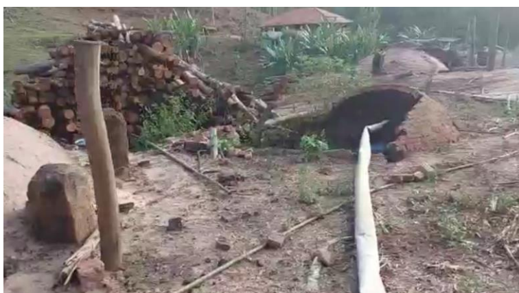
Fig. 07 – Detalhe do local onde a estrutura de um dos fornos cedeu parcialmente
