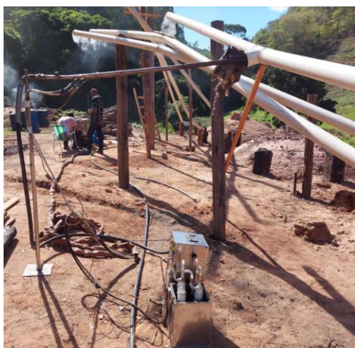
Fig. 24 – Detalhe do ponto de amostragem dos gases
