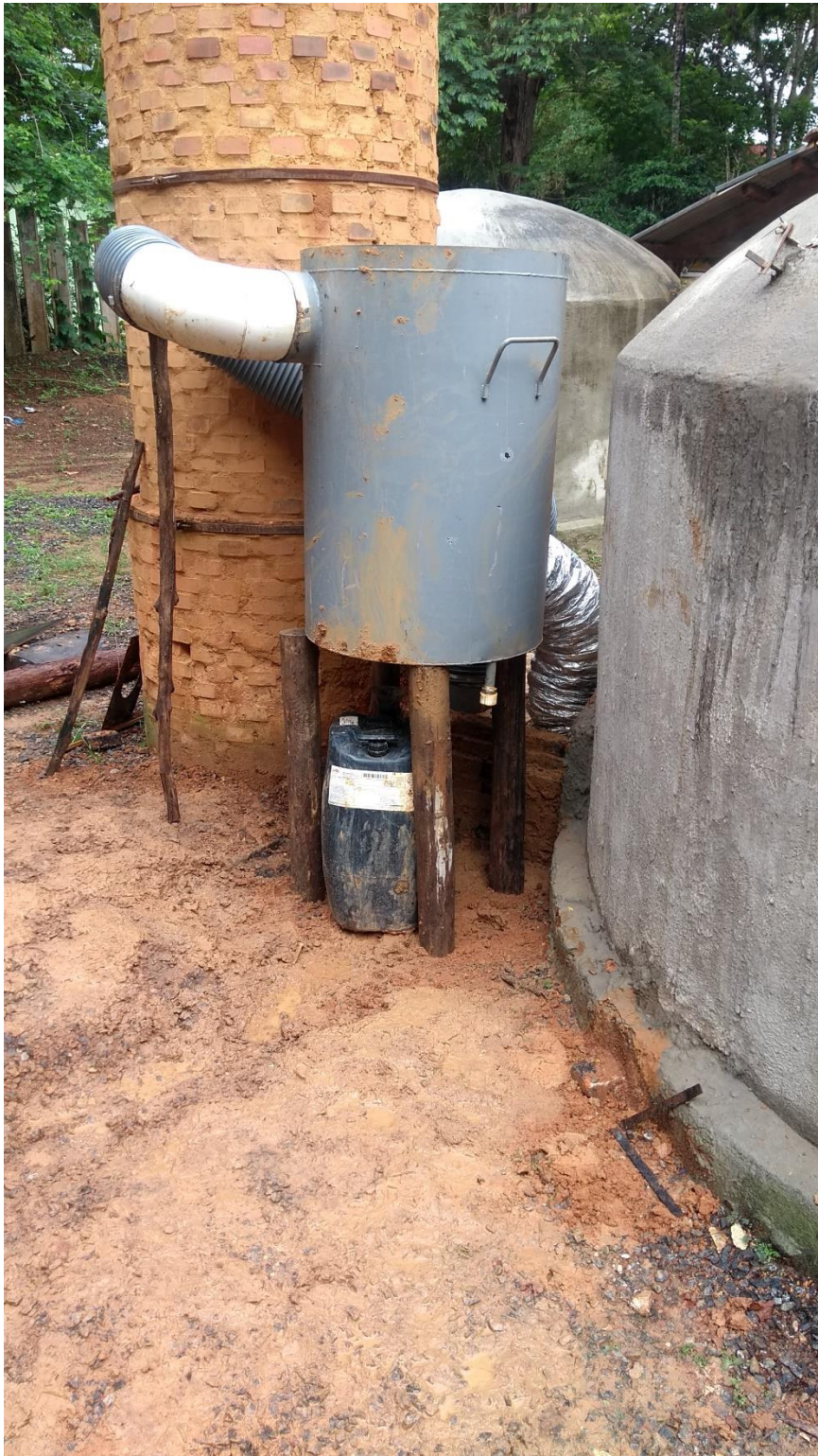
Figura 23 - Vista frontal do recuperador
