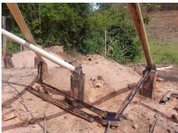
Fig. 10 – Detalhe do sistema de escoamento do condensado
