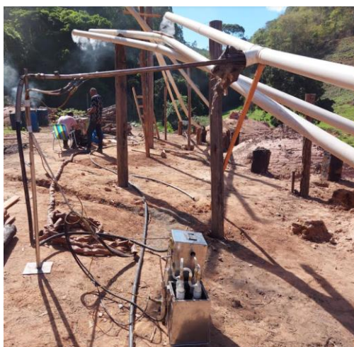
Fig. 24 – Detalhe do ponto de amostragem dos gases
