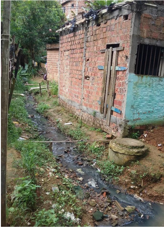
Foto 12 - Lançamento de esgoto e construção irregular às margens do rio. Fonte: PAE Padre Ugo 2018
