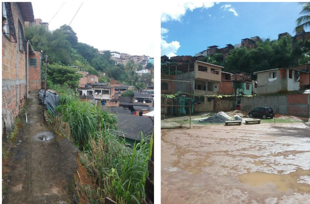
Foto 3 - Residências construídas no topo do talude com sinais de erosão (esc.). Retrato da amplitude da encosta (dir.). Fonte: PAE Beira Dique 2018
