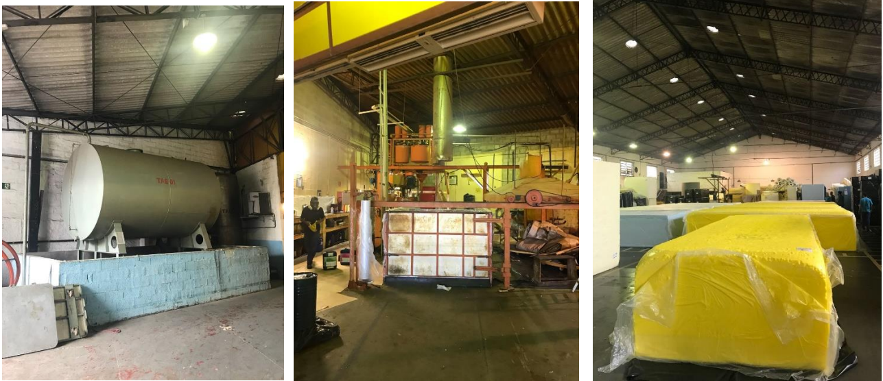
Figura 13 - Automatização do sistema de espumação, misturador e bloco de espuma.
