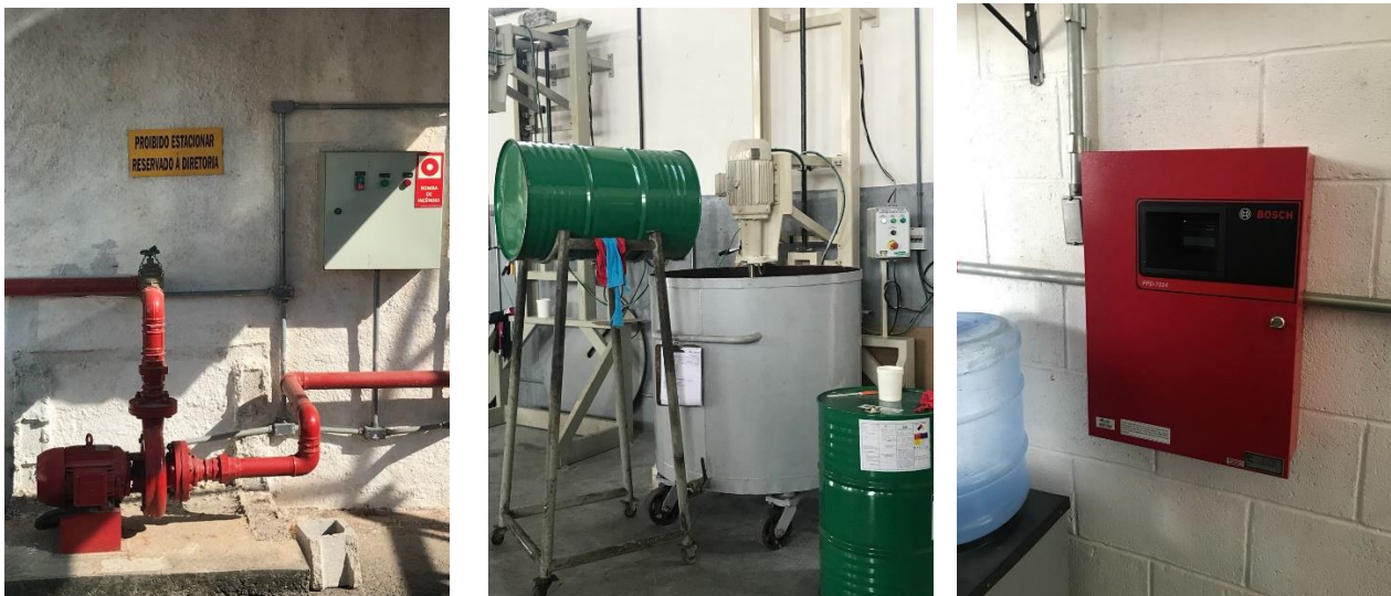
Figura 11 – Adequação da área de armazenagem, agitadores e misturadores com motor a prova de explosão e sensores de emissão e sistema de exaustão.
