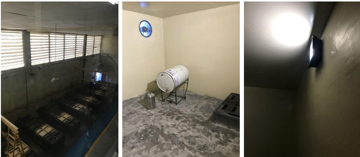
Figura 16 – Aterramentos de estruturas produtivas, contenção de vazamento, porta corta-fogo, sala de inflamáveis com exaustores a prova de explosão, medidor de humidade relativa do ar na sala de inflamáveis, safety chain (container a prova de explosão).
