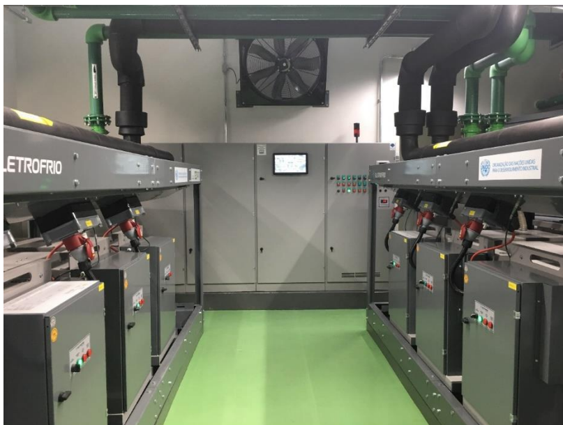
Figura 24. Chillers na casa de máquinas do Supermercado Condor. Fonte: Eletrofrío, email enviado por Rogério Marson Rodrigues.
