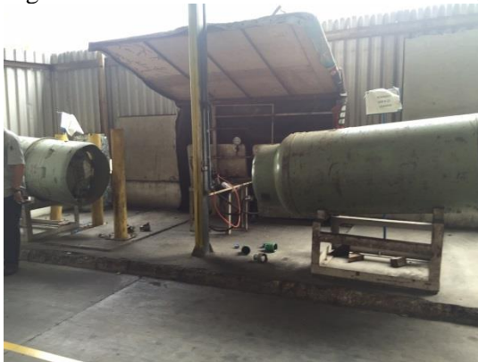
Figura 3: Sistema de fornecimento de fluido (tanques e bombas):
