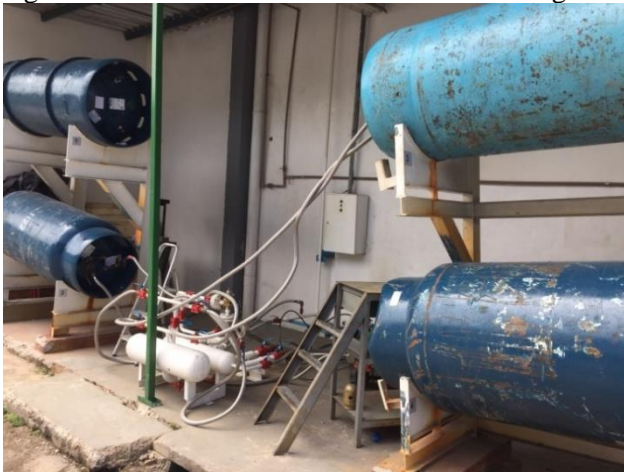
Figura 1. Sistema de fornecimento de fluido refrigerante (tanques e bombas):
